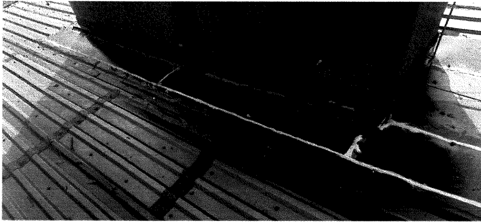
Uszczelnienia styków pokrycia dachowego w okolicy kominów
